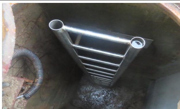
유량계실 수직형 사다리 상태양호
