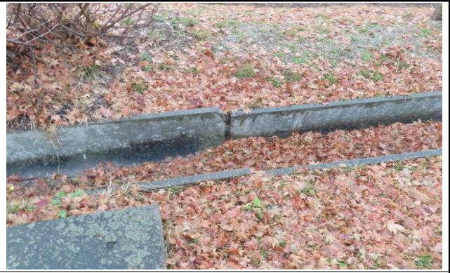
배수시설 배수로 침하
