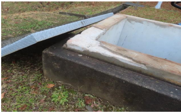
유출밸브실 2지 상부슬래브 몰탈파손
