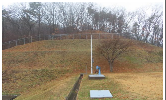
주변사면, 휨스 상태양호
