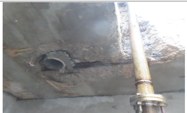
유입밸브실 2지 상부슬래브 철근노출
