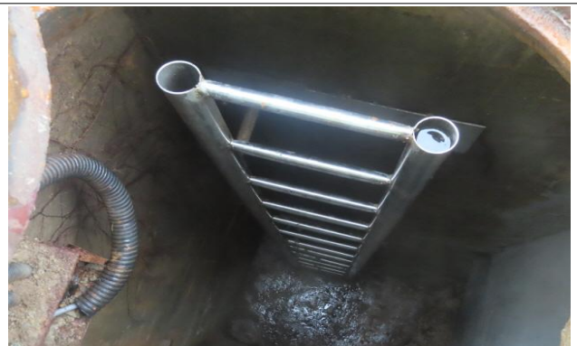
유량계실 수직형 사다리 상태양호
