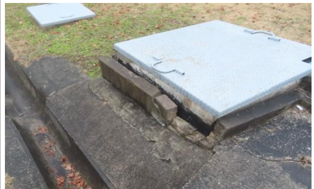
유출밸브실 2지 상부슬래브 몰탈파손
