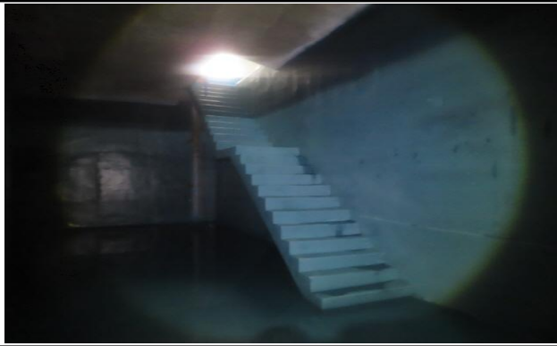
배수지 1지 안전난간 미설치
