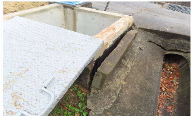
유출밸브실 2지 상부슬래브 몰탈파손
