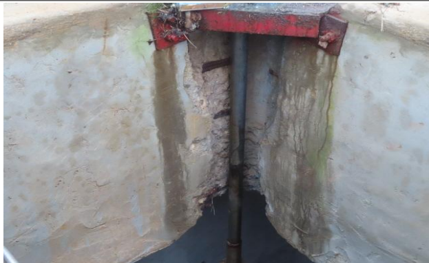
유입밸브실 1지 상부슬래브 철근노출
