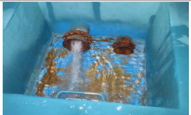
배수지 2지 유출 배관 관부식
