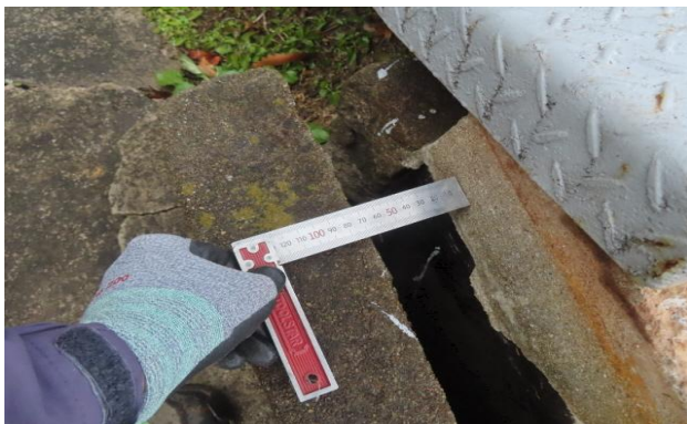
유출밸브실 2지 상부슬래브 몰탈파손
