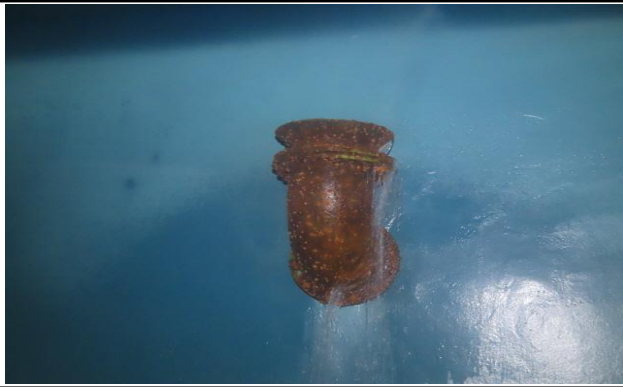
배수지 1지 유입 배관 관부식
