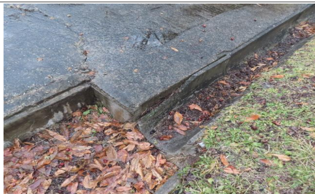
배수시설 배수로 파손
