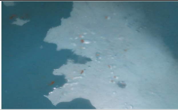
배수지 2지 하부슬래브 도장기포
