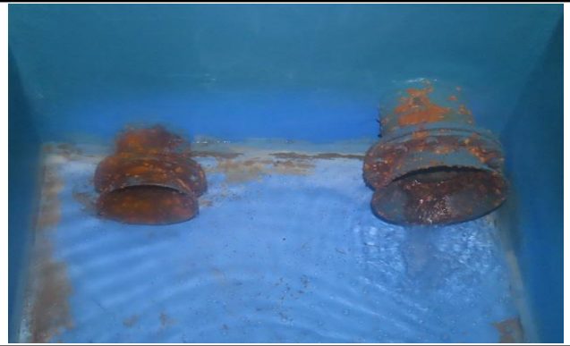
배수지 1지 유출 배관 관부식
