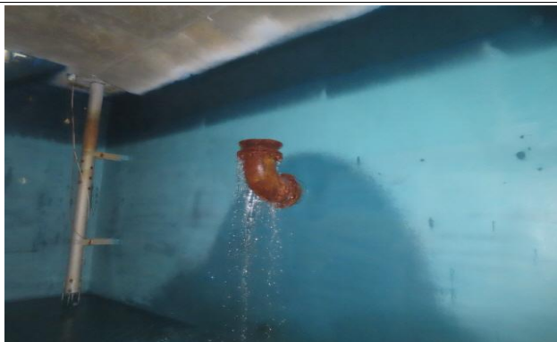
배수지 2지 유입 배관 관부식
